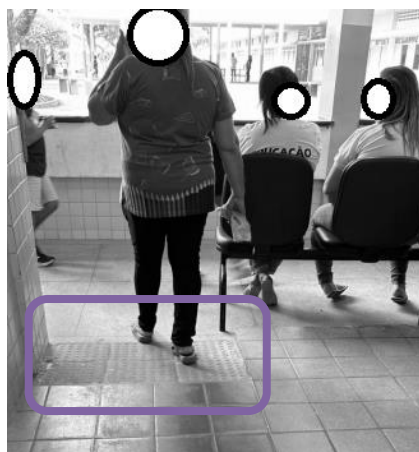
FIGURA 04: DESNÍVEL NO ACESSO DO HALL DE ENTRADA PARA O CORREDOR DE SALA DE AULA
