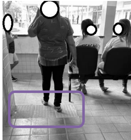
Figura 04 - Desnível no acesso do hall de entrada para o corredor de sala de aula
